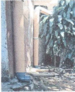
Foto 7: Reparación de red de drenaje y red de agua potable. Limpieza de fosa séptica.
